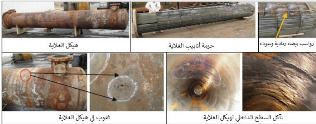
الشكل 4-43: تآكل هيكل غلاية برج النزع في وحدة المعالجة بالأمين
