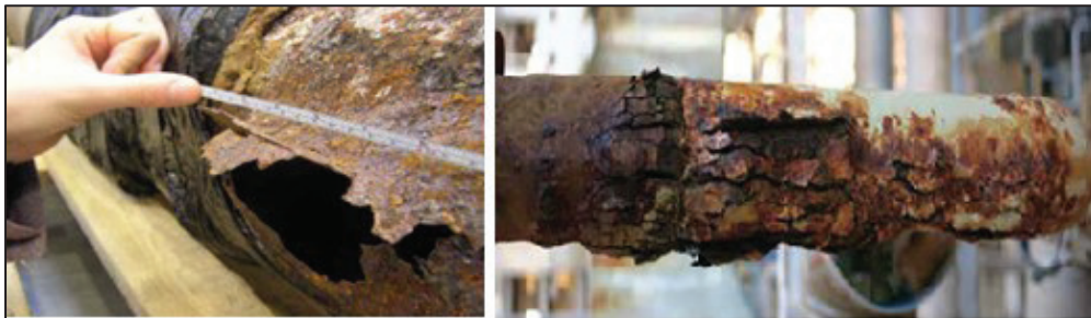
الشكل 1-20: تآكل أنبوب بسبب تلف العزل الحراري
