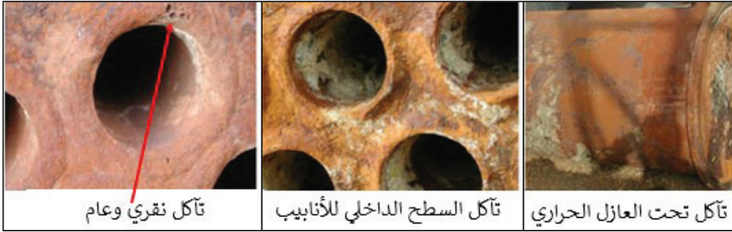
الشكل 4-39: تآكل مسخنات الغاز الحامضي الداخل إلى وحدة استرجاع الكبريت
