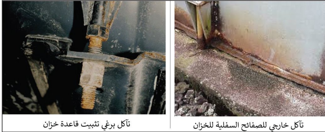
الشكل 4-45: تآكل خارجي بتأثير العوامل الجوية في خزان سطحي
