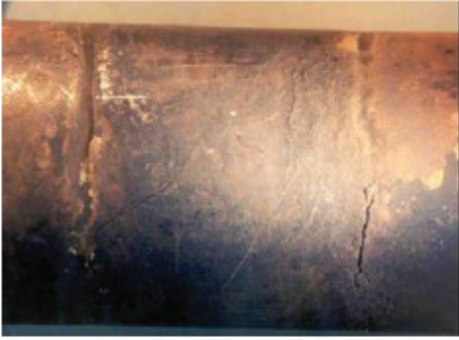
الشكل 4-52: تآكل إجهادي تشقي في أنبوب مرجل بخاري في المناطق المتأثرة باللحام
