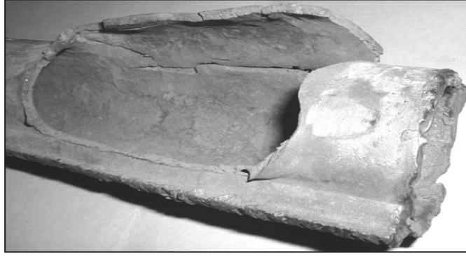
الشكل 4-53: شق مفتوح جزئياً على شكل نافذة في أنبوب المبخر
